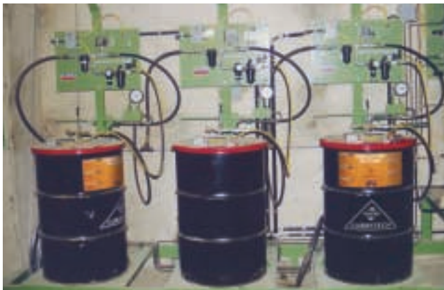
Zentrale Schmierstoffversorgung mit CEPLATTYN KG 10 HMF. Central lubricant supply with CEPLATTYN KG 10 HMF.
