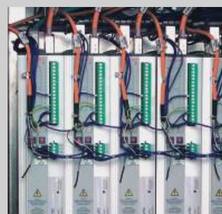
Ansteuerung von 9 Achsen mit 9 PA-CONTROL servoTEC Handling of 9 axis with the means of 9 PA-CONTROL servoTEC
